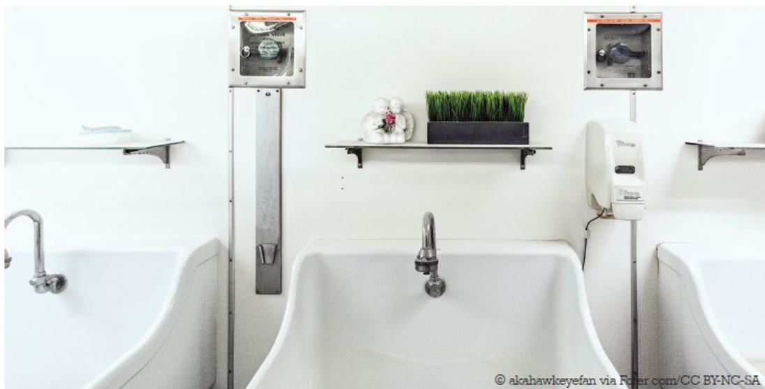
Gráfico 3.2.2. Estación de lavado de emergencia
